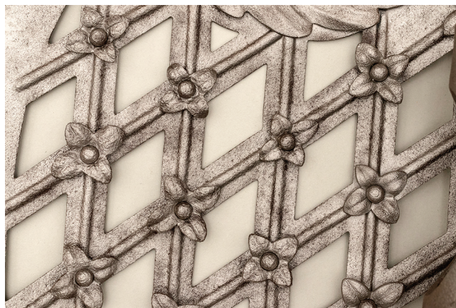
3. kép. Részlet a felső rész perforált lemezéről, tisztítás után.
