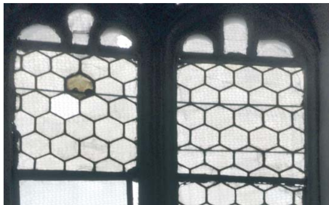
3. kép. Az erősen romlott ablakok szétesését az üveg elé helyezett védőháló késleltetheti.
