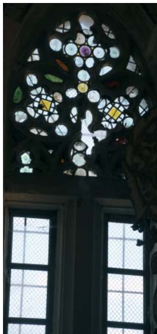
19. kép. A szászivánfalvi templom ablakának felső része a belső oldalról. A szétesés határára lévő üvegeket csak a sodronyok tartják a kizuhanástól.
