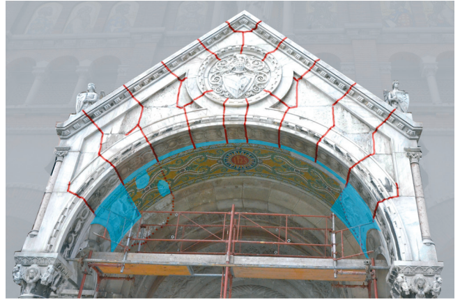
Szeged, dóm főkapu heveder mozaik, a károsodások és a portikusz köelemek által lejutó nedvesség lehetséges útjainak összefüggései ● köelemek fugái ● a mozaikot érintő hiányok, elváltak frontjai és túltelített köszegtyő
