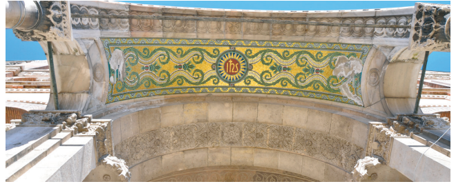
15. kép. A portikusz mozaik sérült, hiányos alsó szakaszai egyértelműen utaltak a beázási problémára. 2015. márciusi állapot.
