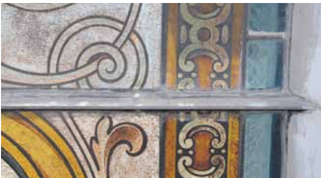
19. kép. Tömítés nélküli T profil tartószerkezet. Az üvegmezőket a fémbe fűrt fastiftek tartják a kittágy alatt. Kalocsa, érseki főszékesegyház.
