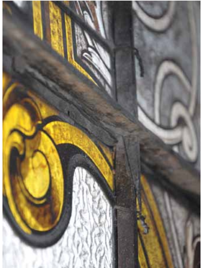
20. kép. Fém tartó és rögzítő szerkezet csatlakoztatása tömítés nélkül. Kalocsa, érseki főszékesegyház.
