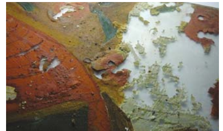
9–10. kép. Felhólyagosodott, illetve hiányzó festékréteg.
