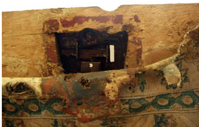
11. kép. Zár környékéről leszakadt textilborítás.
