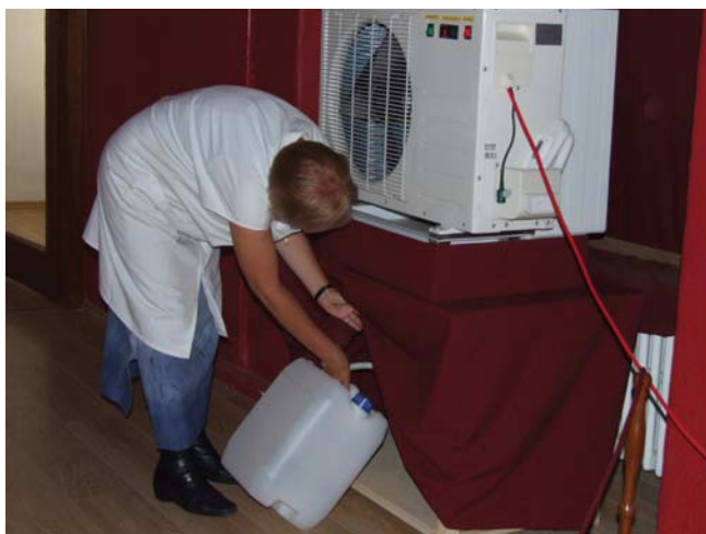
8. kép. A kondenzvíz eltávolítása.
