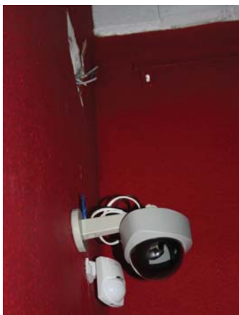
4. kép. Korszerű biztonságtechnikai berendezés.
