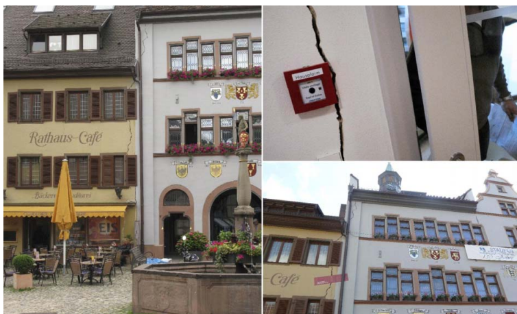
4. ábra. Balul végződött talajszondás hőszivattyú-telepítés Staufenben: a városháza környékén megemelkedett talaj megrepesztette az óváros sok épületének falát.
