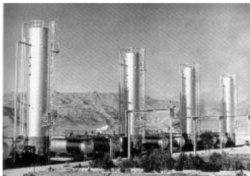
Gáztalanító, víztelenítő berendezések Iránban
