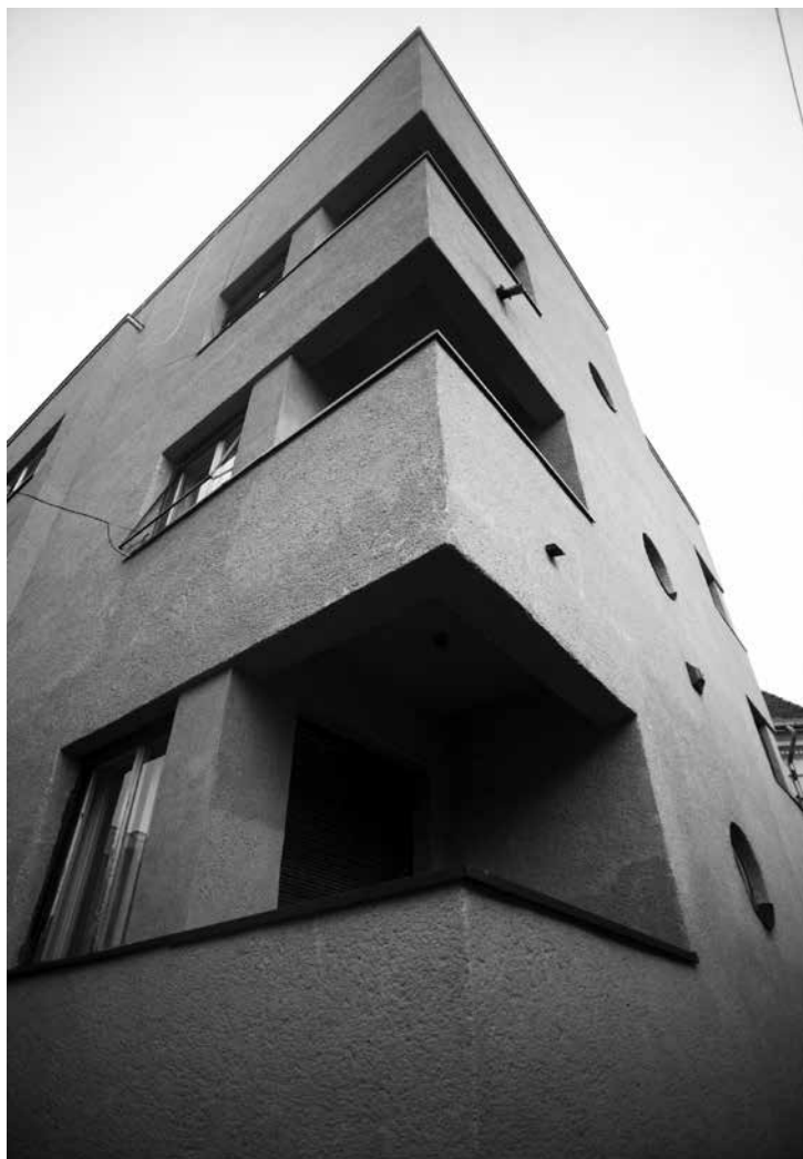
Megőrzött modernizmus. A kolozsvári unitárius lelkészi hivatal a Brassai utca 6. szám alatt (Deák Ferenc irodája, 1938–39) rehabilitált kőporos (teraszit) vakolata © Zuh Deodáth
