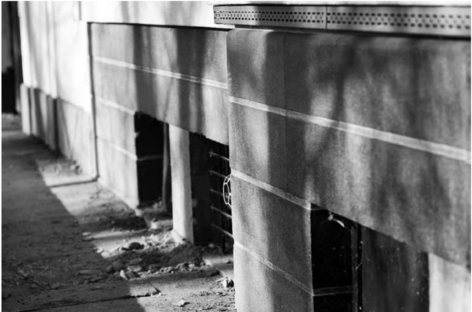
Sérülékeny modernizmus. A Friedmann-ház eredeti műkő lábazata, fölötte a fal síkjából kiugró hőszigetelő réteg a műanyag nemes vakolattal, 2022 elején © Zuh Deodáth
