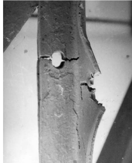
8. ábra Egy függőleges rúd szakadása a szögecslyuk környezetében
